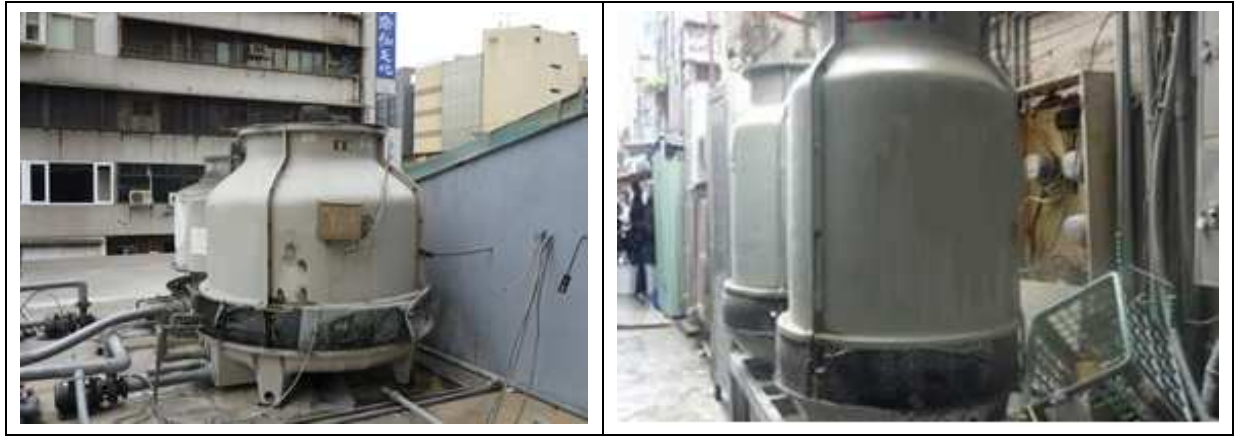
圖 12 冷卻水塔設備實景圖
