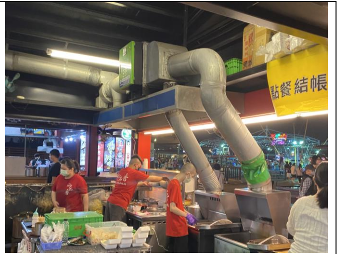
新北市—樹林興仁花園夜市 油煙排放管線設計良好
