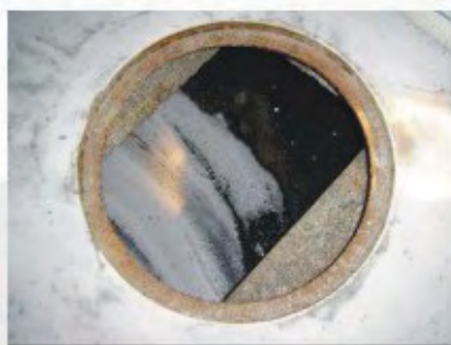
浮渣或浮油未清除
