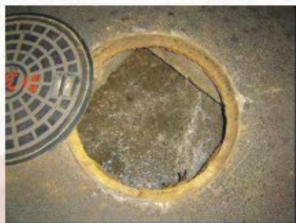
初沉池篩渣、污泥 或浮油久未清除
