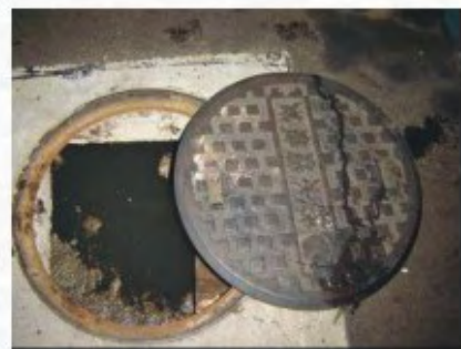
浮渣或浮油未清除
