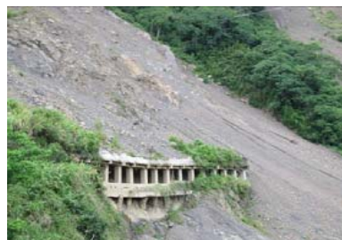
濁水溪上游崩塌情形
