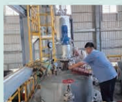
圖5 工業級熱裂解系統之裂解槽
